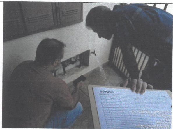
Figura2—Verificação da vazão máxima e da vazão mínima fornecida para a residência.
