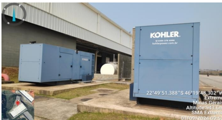
Figura 9. Geradores de energia localizados na face Norte do galpão.
