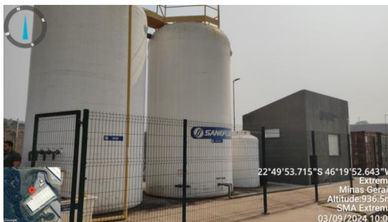
Figura 12 Estação de Tratamento de Efluentes Sanitários.
