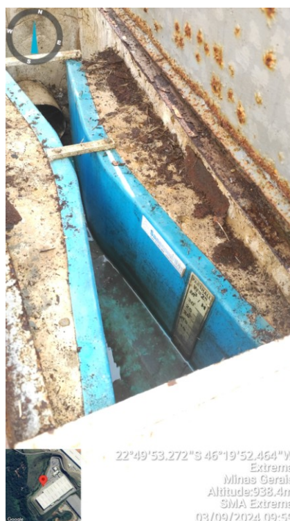
Figura 13. Sistema medidor de vazão ETE
