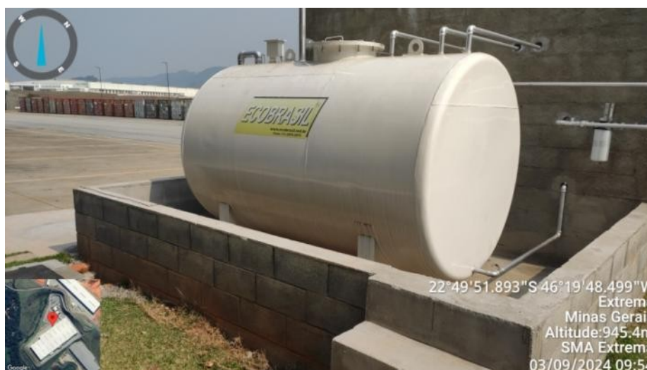
Figura 10. Tanque de armazenamento de diesel utilizado para os geradores.
