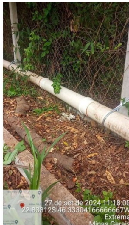
Figura 16. Ponto de vazamento após reparo (Fonte: Informação complementar)
