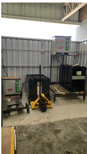
Figura 6. Área de recarga de baterias da Fujitsu.
