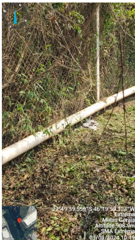
Figura 15. Ponto de vazamento efluente tratado.
