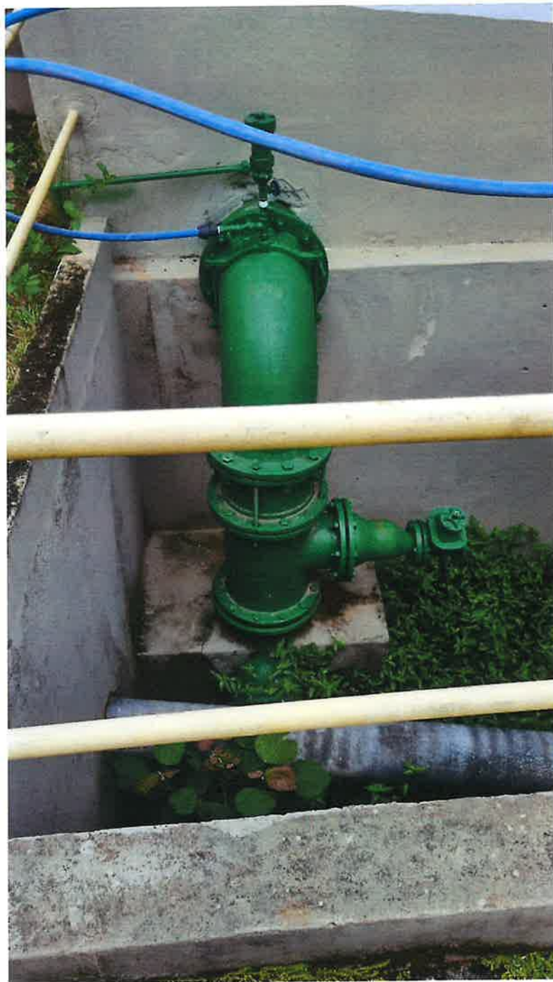
Figura 16 - EAB Jaguari – Tubulação e válvulas
