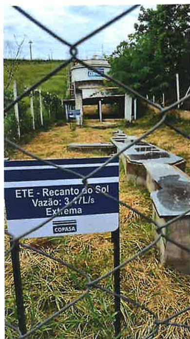
Figura 174 - ETE Recanto do Sol - Placas suspensas
