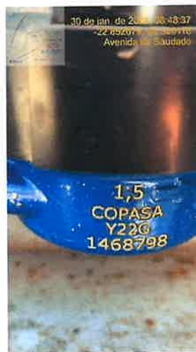
Figura 72 - Hidrômetro Avenida da Saudade
