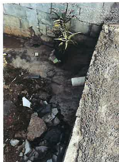
Figura 103 - Lançamento Irregular - Avenida Gov. José Ferreira
