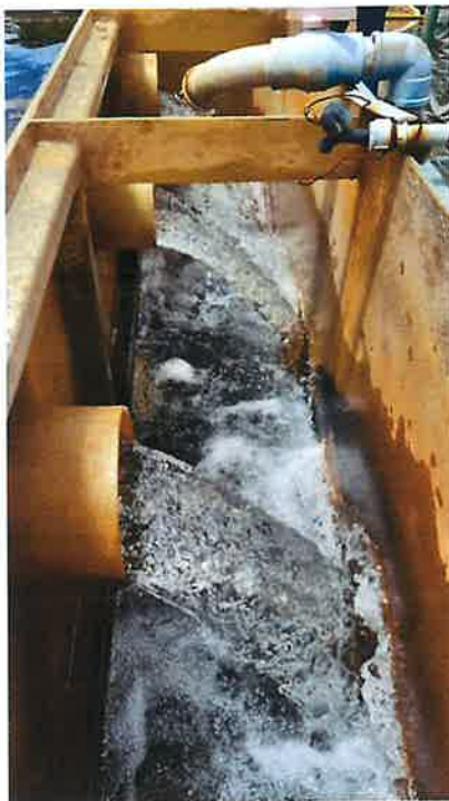
Figura 40 - Água Tratada ETA Jaguari
