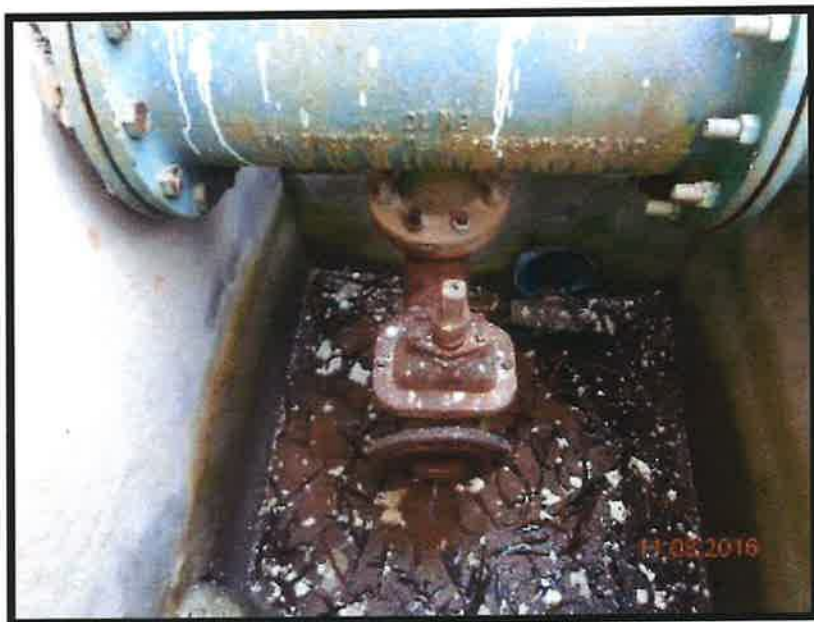
Figura 55 - Vazamento em registro localizado na área do BST-5
