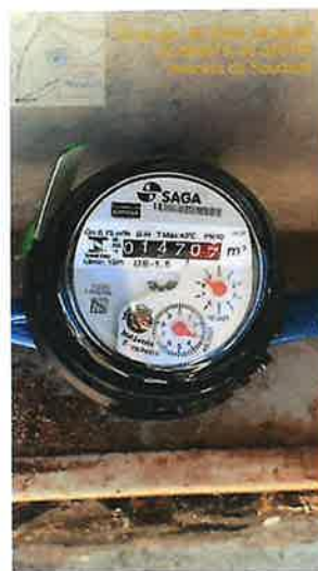
Figura 73 - Figura 64 - Hidrômetro Avenida da Saudade
