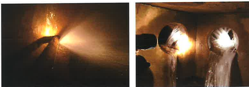
Figura 190 - Vazamentos Não Visíveis
