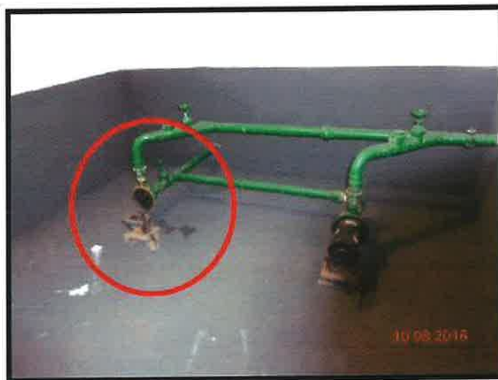
Figura 56 - Booster 8 sem CMB reserva instalado.
