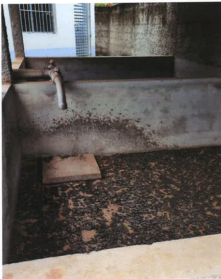
Figura 135 - ETE Barreiro - Leito de Secagem
