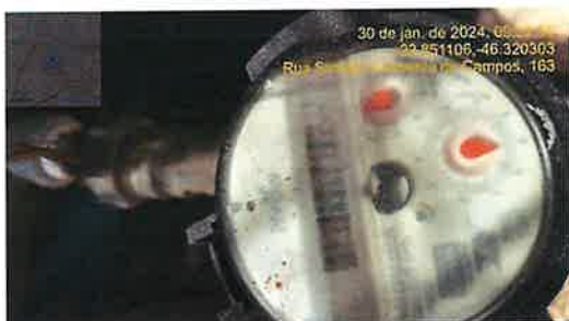
Figura 75 - Hidrômetro Simeão Clemente Campos
