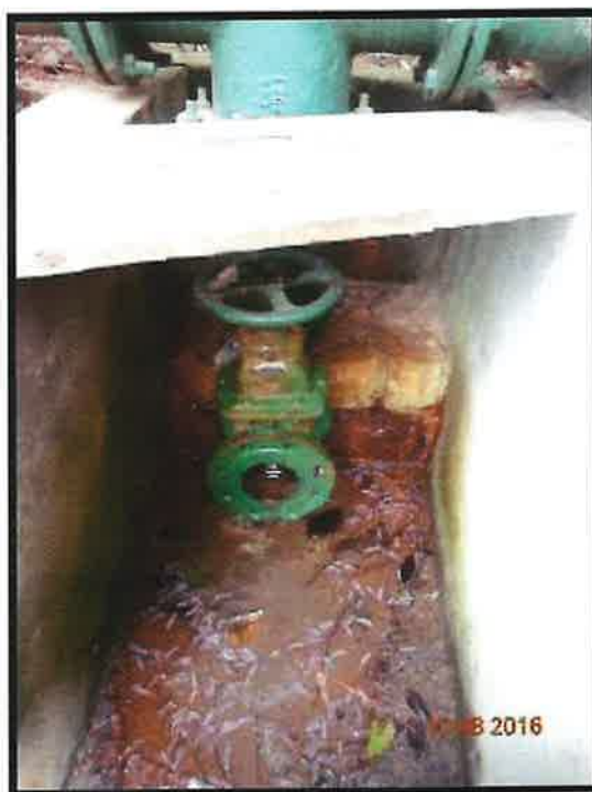
Figura 54 - Vazamento em registro localizado na área do BST-1
