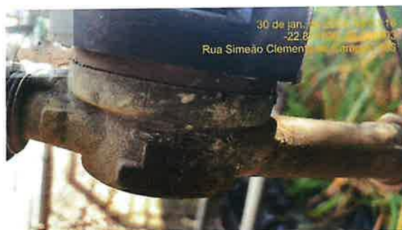
Figura 77 - Hidrômetro Simeão Clemente Campos
