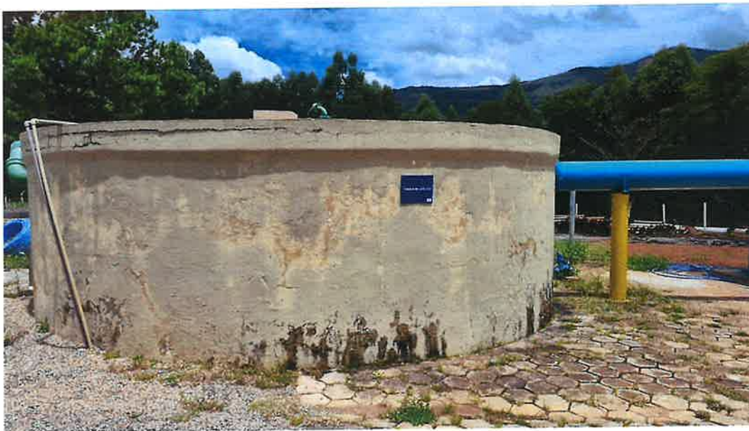
Figura 33 - Tanque de Contato
