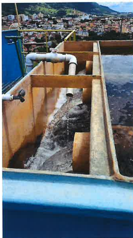
Figura 41 - Estruturas ETA Jaguari (Fibra)
