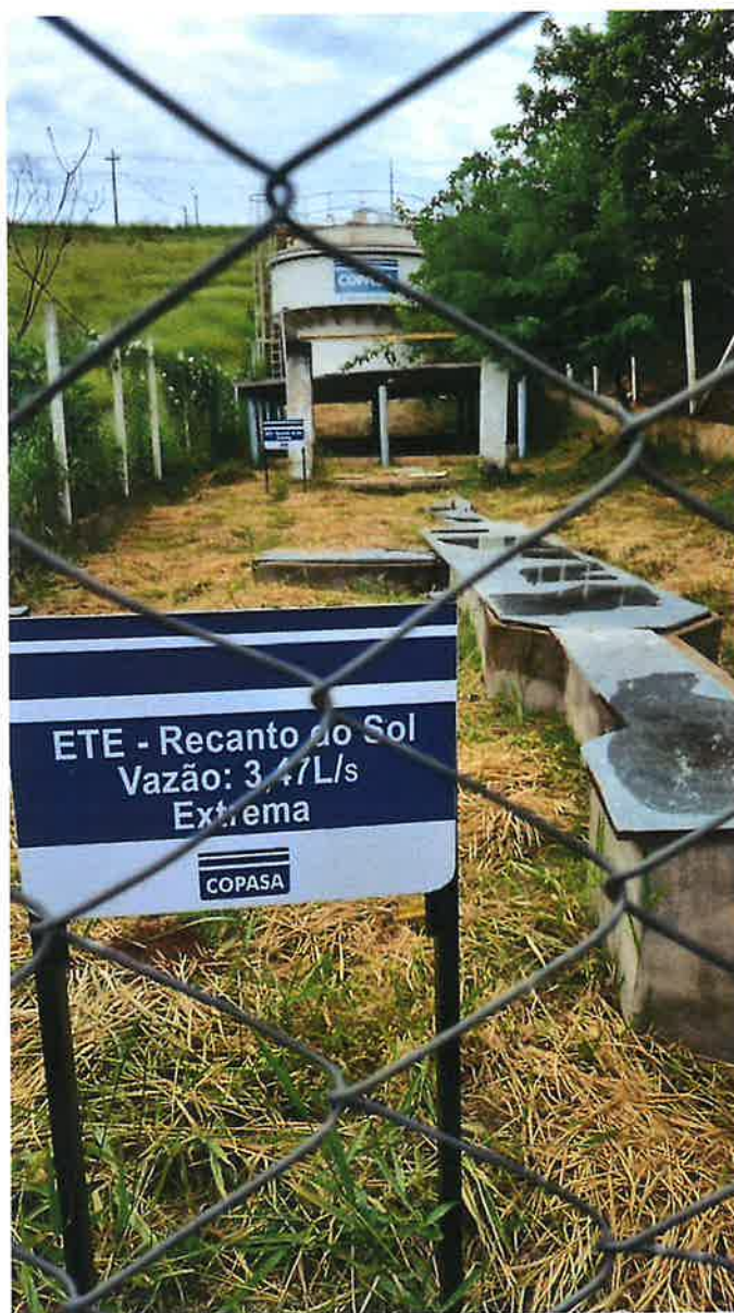
Figura 131 - ETE Recanto do Sol
