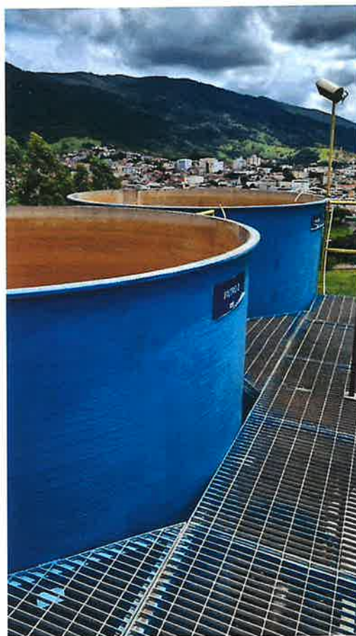
Figura 42 - Filtros ETA Jaguari
