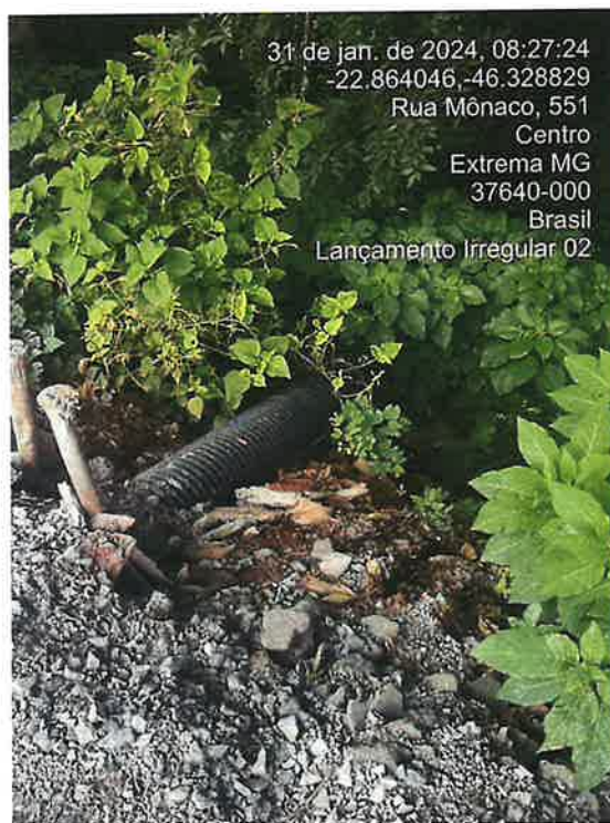
Figura 98 - Lançamento Irregular - Rua Mônaco
