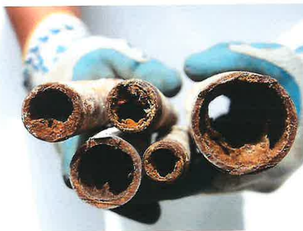
Figura 183 - Incrustação em Tubulações.
