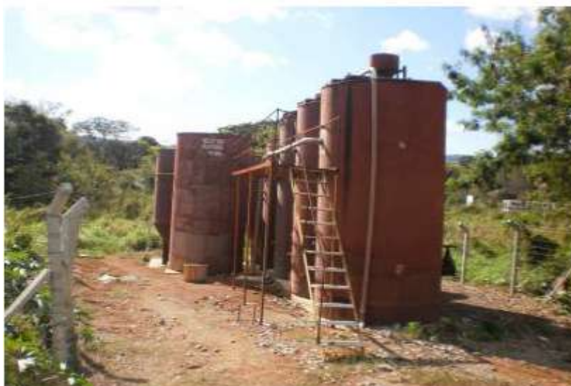
Reatores em fibra ETE Jardim Mantiqueira
