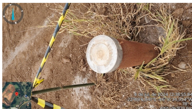
Figura 21. Poço tubular perfurado, informado que não será utilizado (notificado executar tamponamento)
