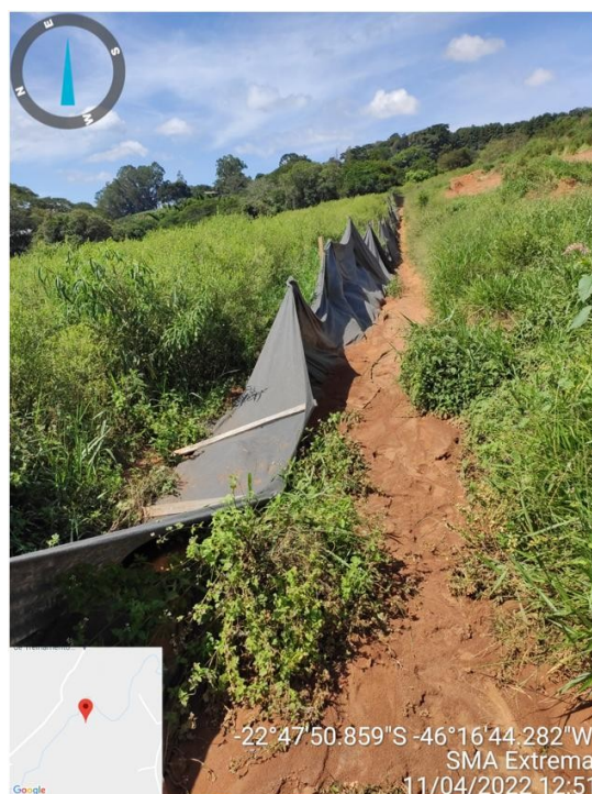
Figura 20. Manta geotêxtil caída (sem função de contenção)
