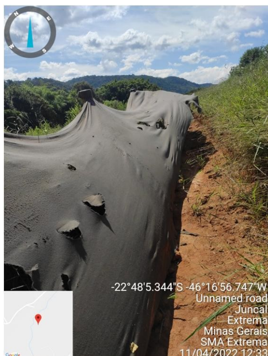
Figura 19. Manta geotêxtil solta (sem função de contenção)
