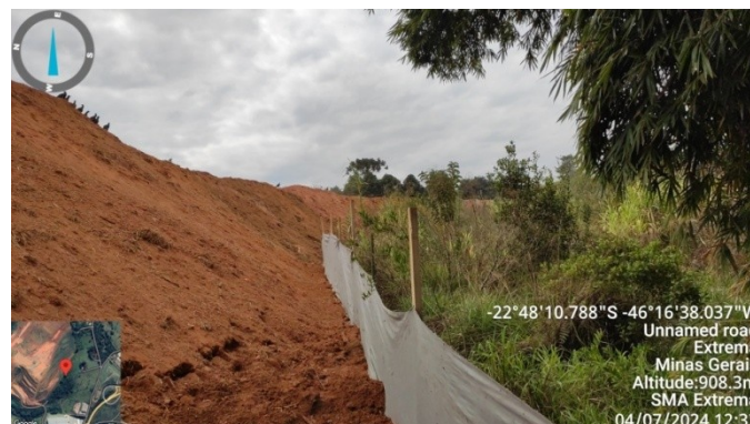
Figura 23. Solo disposto nas margens da delimitação com a APP da nascente com manta geotêxtil (sem outras ações de contenção).
