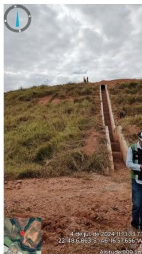
Figura 32. Escada hidráulica ausente no projeto
