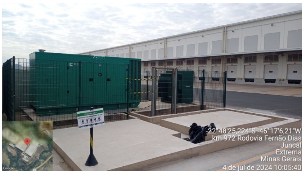
Figura 10. Gerador utilizado pelo empreendimento e base em concreto para a instalação do segundo gerador.
