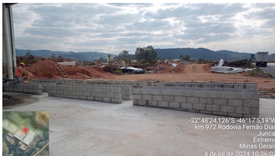
Figura 08. Local de instalação das condensadoras
