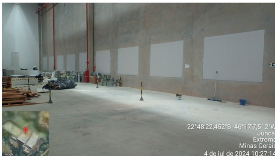
Figura 09. Local de instalação da sala de recarga de baterias.
