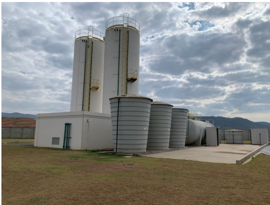
Figura 11. Estação de tratamento de efluentes do condomínio.
