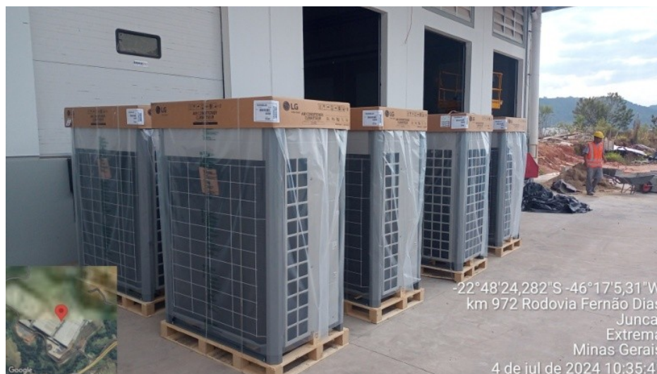
Figura 07. Condensadoras do sistema de refrigeração
