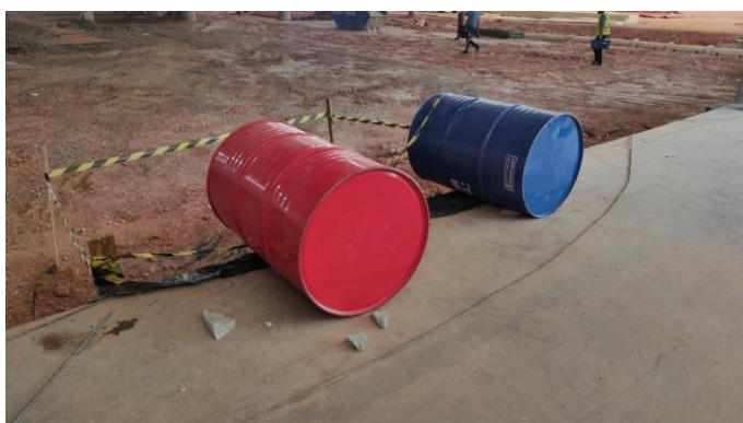
Figura 7. Área de Armazenamento 3, polipropileno utilizando para isolamento do piso.
