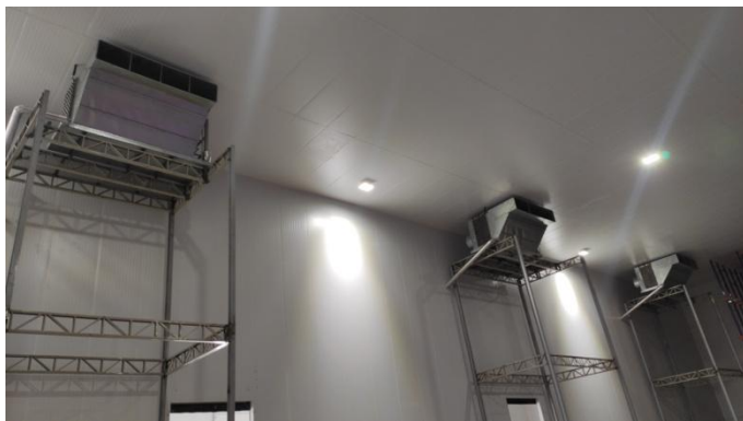
Figura 9. Sistema de resfriamento interno do Módulo 1.
