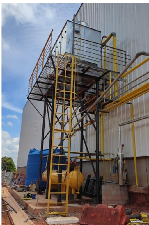
Figura 16. Condensadora com tanque para armazenamento de amônia e caixa d'água para suporte.
