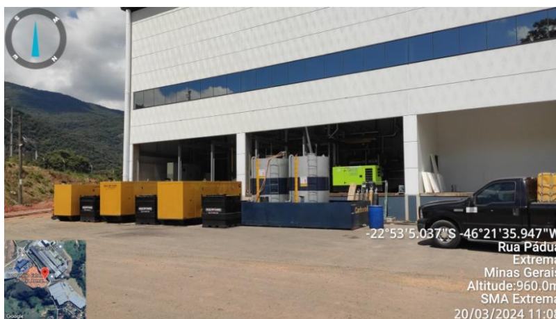
Figura 17. Geradores e tanques de diesel utilizados durante a instalação do empreendimento.
