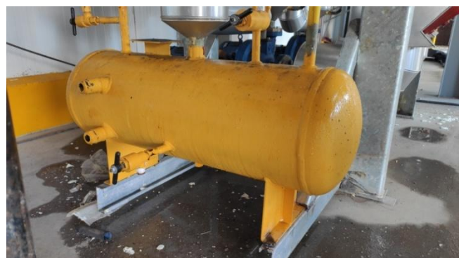
Figura 15. Tanque para armazenamento de água de purga dos compressores.
