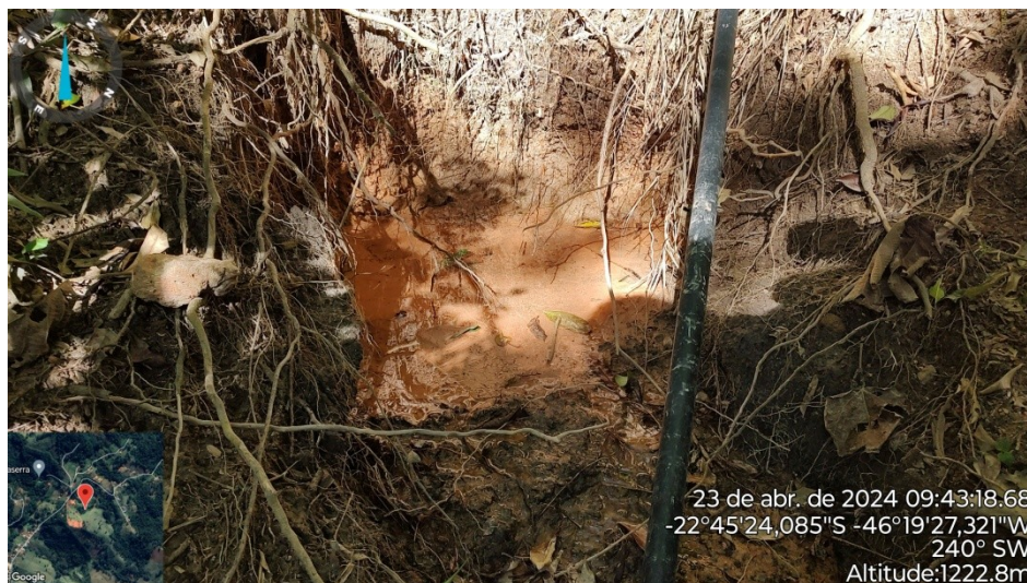
Figura 11. Localização da nascente, com evidências de carreamento de solo e assoreamento.
