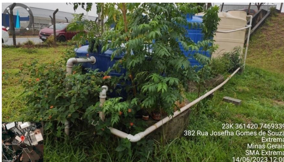
Figura 22. Tanques adicionais de decantação da ETE e saída do efluente tratado para tubulação de emissário.
