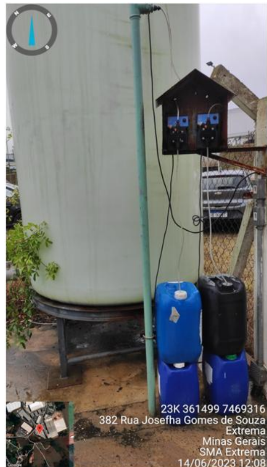
Figura 26. Local de inserção de cloro na água captada
