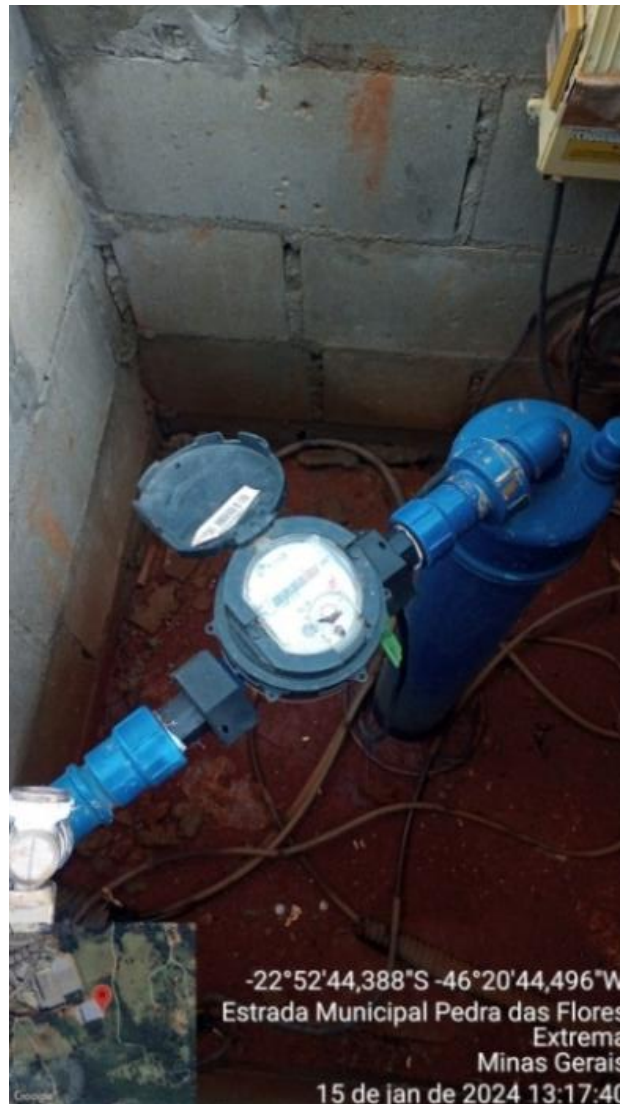
Figura 43. Poço tubular subterrâneo localizado a leste (fundos) do G10
