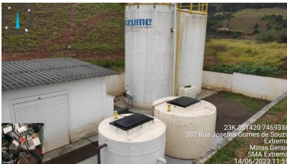
Figura 21. Estação de Tratamento de Efluentes (ETE).
