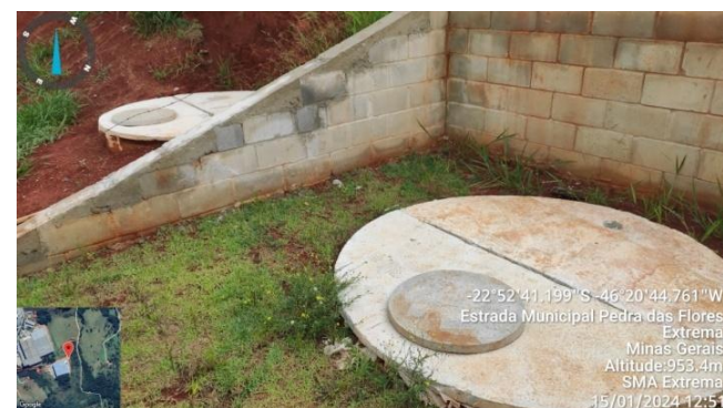
Figura 42. Sumidouros da ETE instalada no G10.
