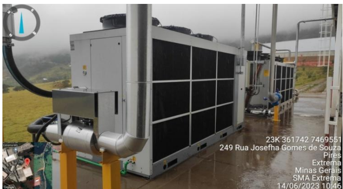
Figura 16. Chillers do sistema de refrigeração.
