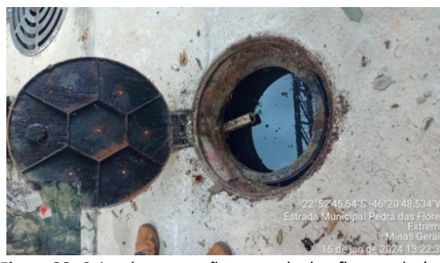
Figura 38. Caixa de contenção saturada do efluente da área de recarga
