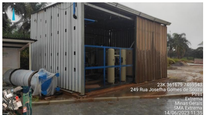
Figura 20. Local onde estão alocados os compressores de suporte a operação.
