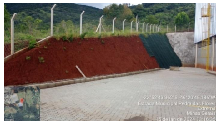
Figura 34. Talude sem cobertura vegetal a leste (fundos) do G10.
