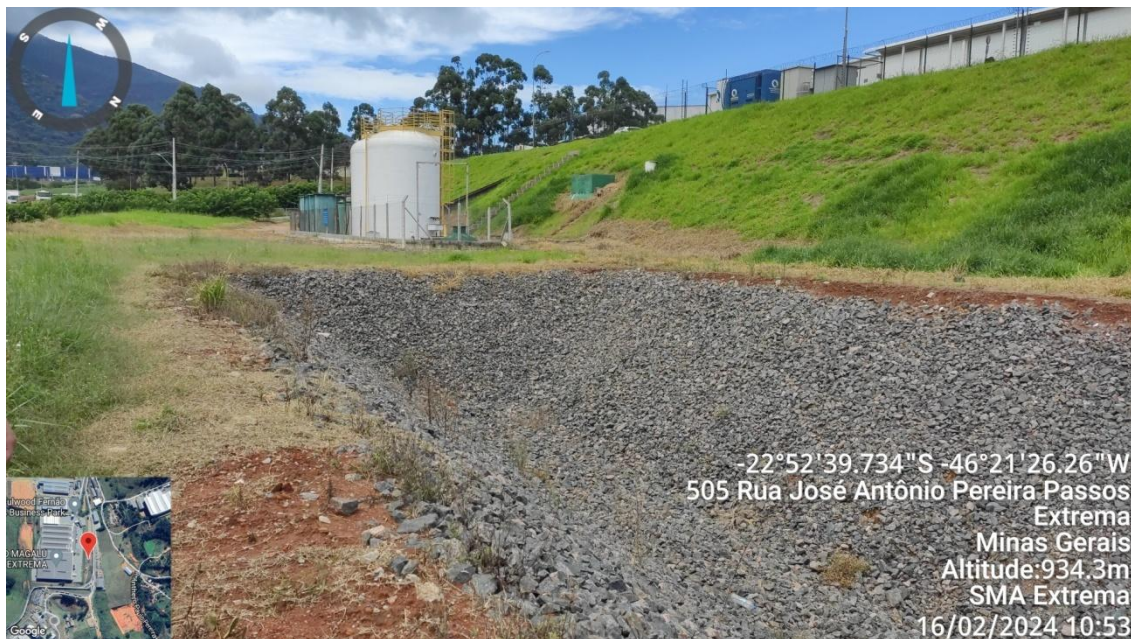
Figura 14. ETE do condomínio logístico-industrial e primeiro dos 3 sumidouros instalados para recebimentos do efluente tratado.
