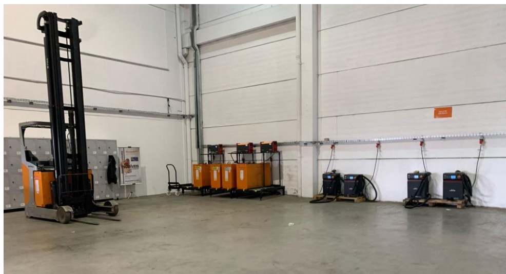
Figura 6. Área de recarga de empilhadeiras elétricas
