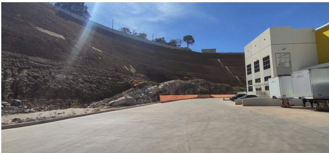
Figura 16. Talude não finalizado/revegetado no entorno do galpão G400. (registro de 26/05/2023)
