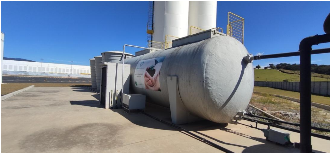
Figura 15. ETE do condomínio.
