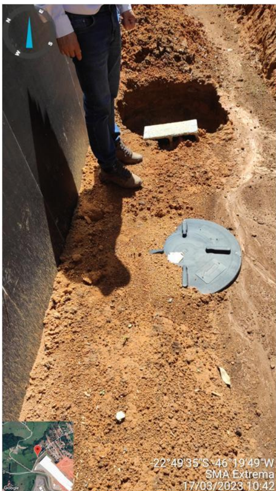
Figura 11. Biodigestor para atendimento ao canteiro de obras.
