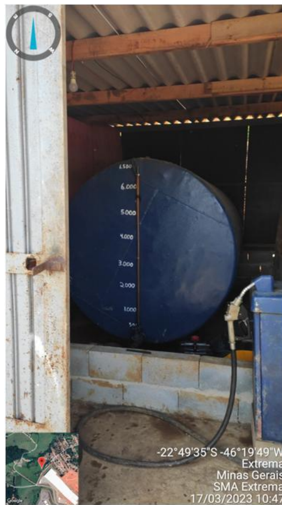
Figura 12. Tanque de óleo diesel para abastecimento de maquinários.
