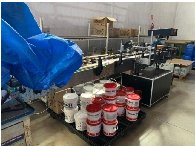
Figura 14. Equipamento para envase automático desativado.
