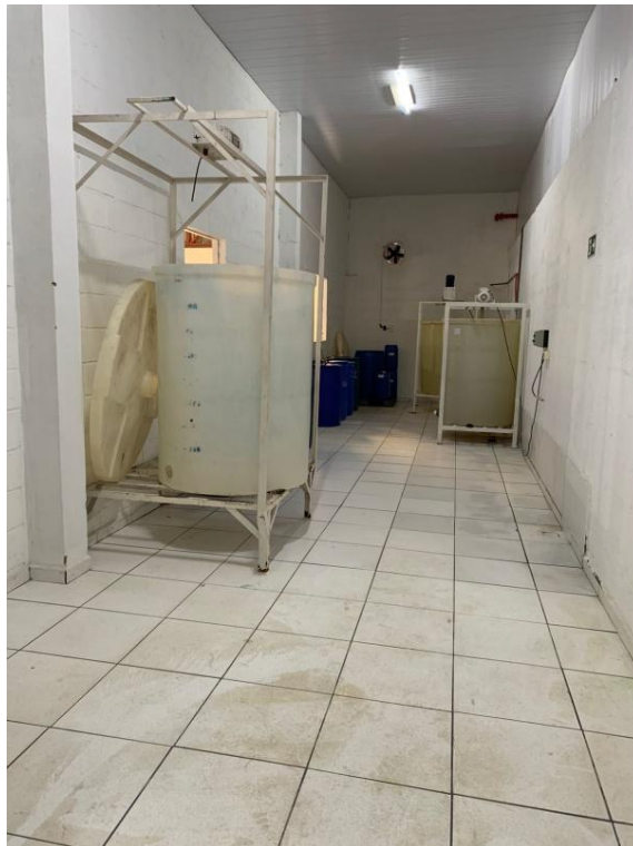
Figura 10. Área para produção de produtos clorados.
