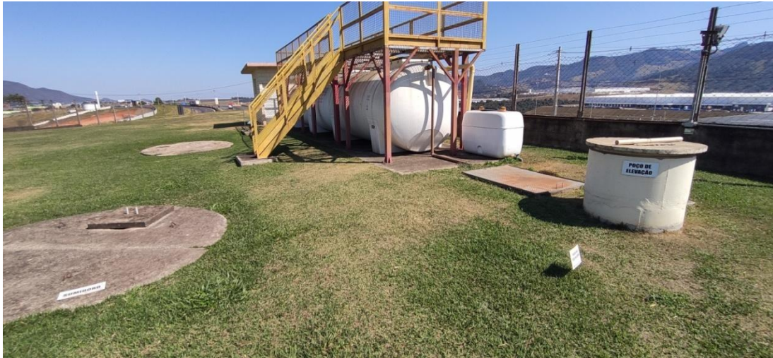
Figura 22. Estação de tratamento de efluentes sanitários do empreendimento.
