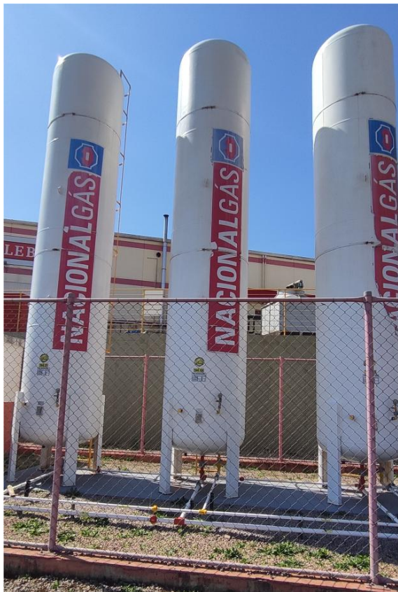
Figura 17. Tanques para armazenamento de GLP para sistema de aquecimento.
