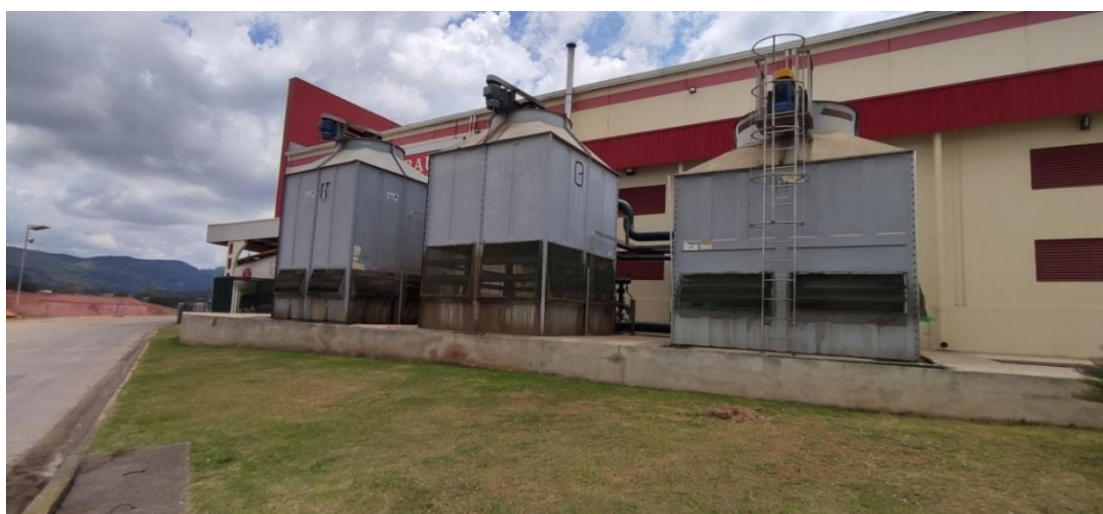
Figura 15. Sistema de refrigeração do empreendimento.
