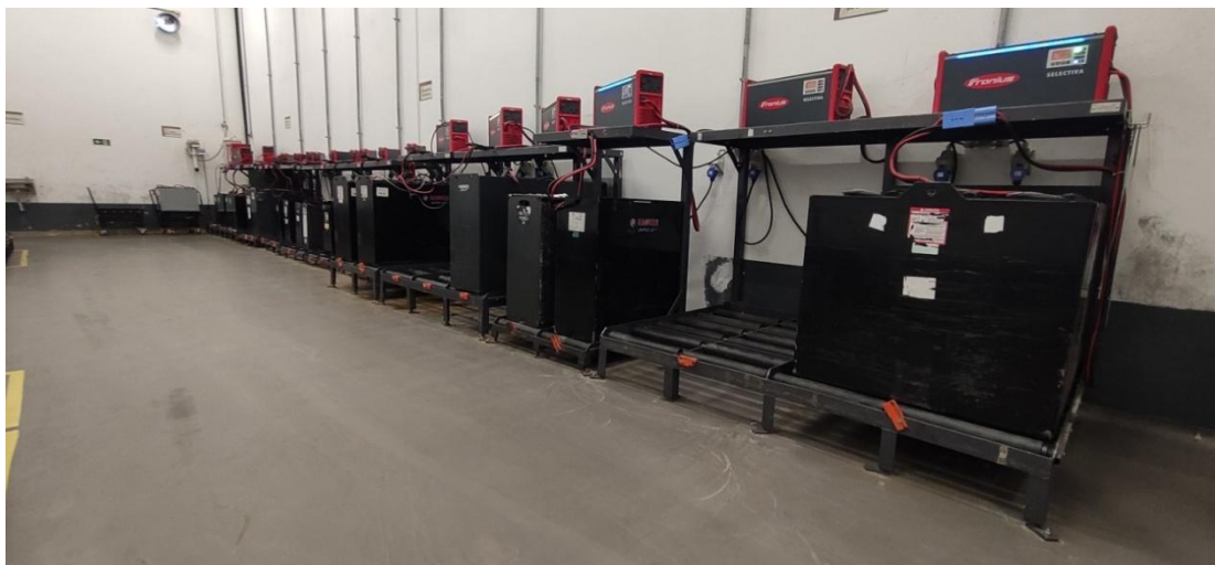
Figura 13. Sala de recarga de baterias.
