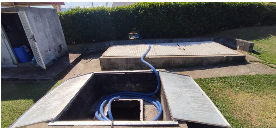
Figura 21. Local de armazenamento de efluentes líquidos industriais.
