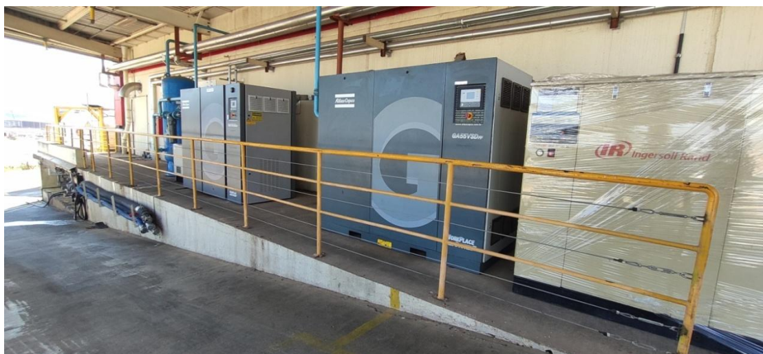
Figura 14. Área dos compressores.
