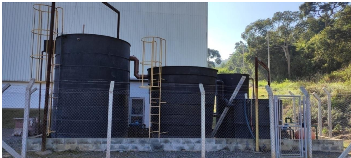
Figura 9. Estação de tratamento de efluentes líquidos antes da ampliação
