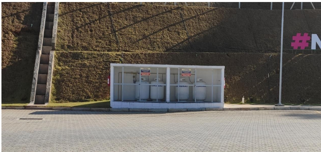
Figura 5. Central de armazenamento de GLP.
