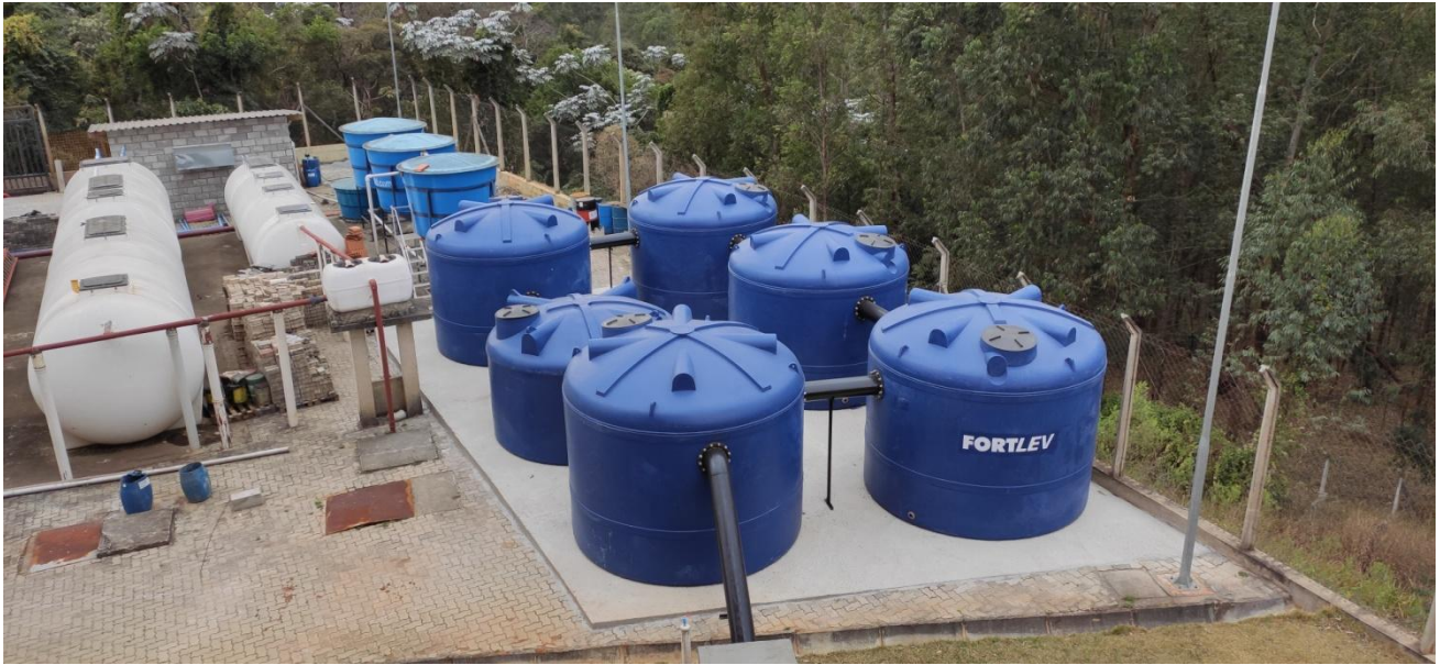
Figura 16. Sistema de Tratamento de Efluentes (em branco) e reservatórios de contenção em caso de vazamentos (em azul).
