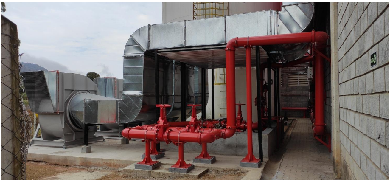
Figura 15. Sistema de exaustão que dá suporte a área de armazenamento de produtos inflamáveis e sistema de combate à incêndio.
