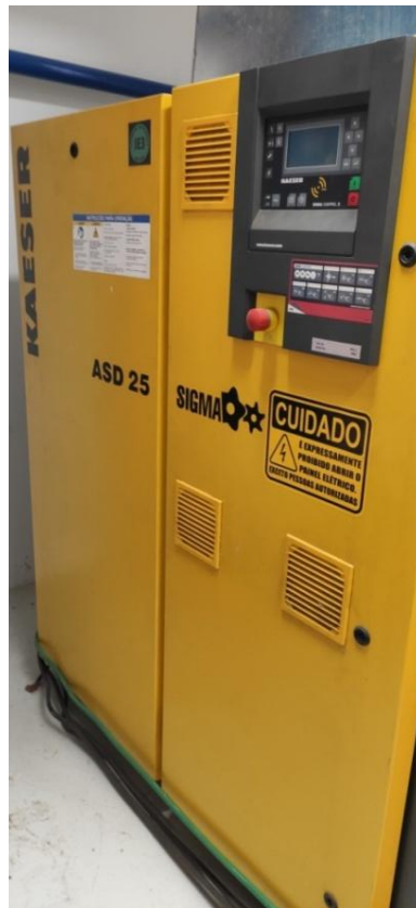
Figura 12. Compressor utilizado pelo empreendimento.
