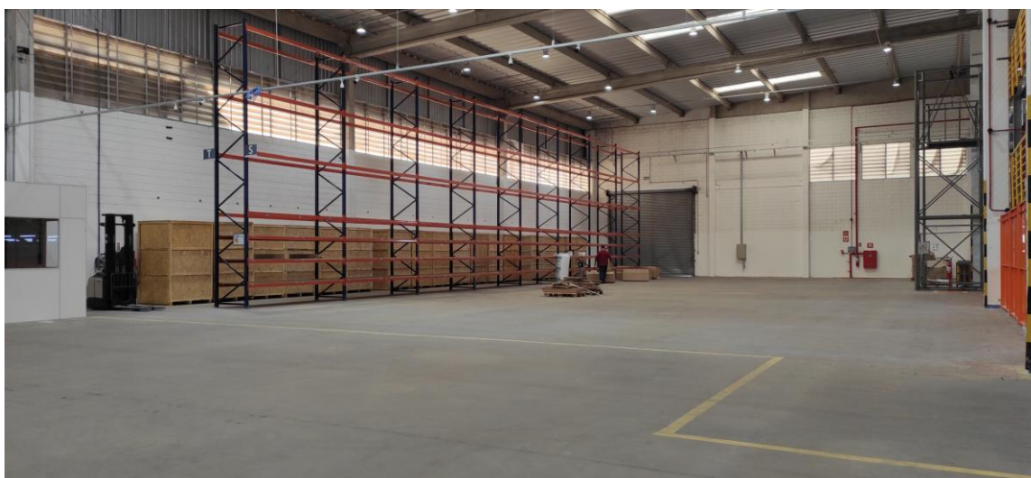
Figura 6. Vista da área de armazenamento de produto acabado em estantes porta-paletes (em instalação).
