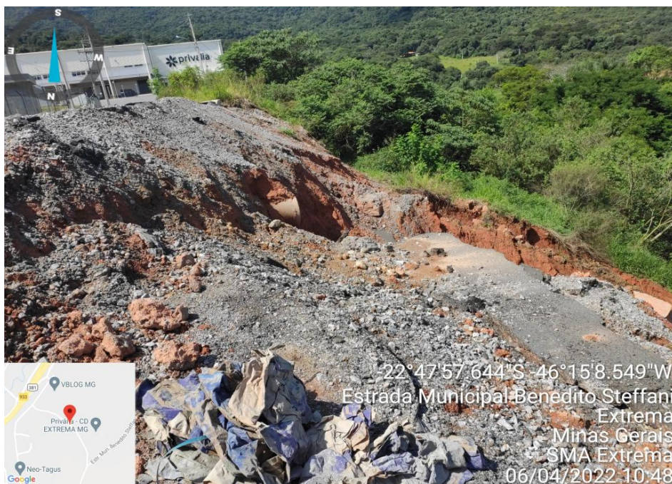
Figura 16. Vista do deslizamento da Estrada Municipal Benedito Steffani.
