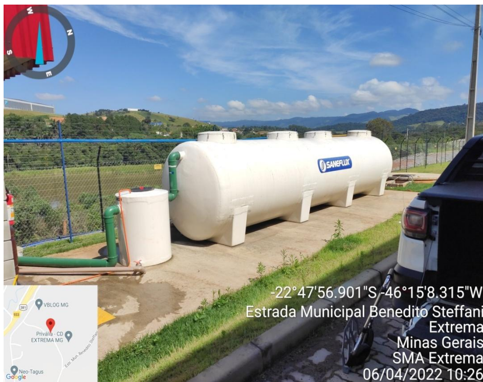
Figura 13. Estação de Tratamento de Efluentes sanitários.
