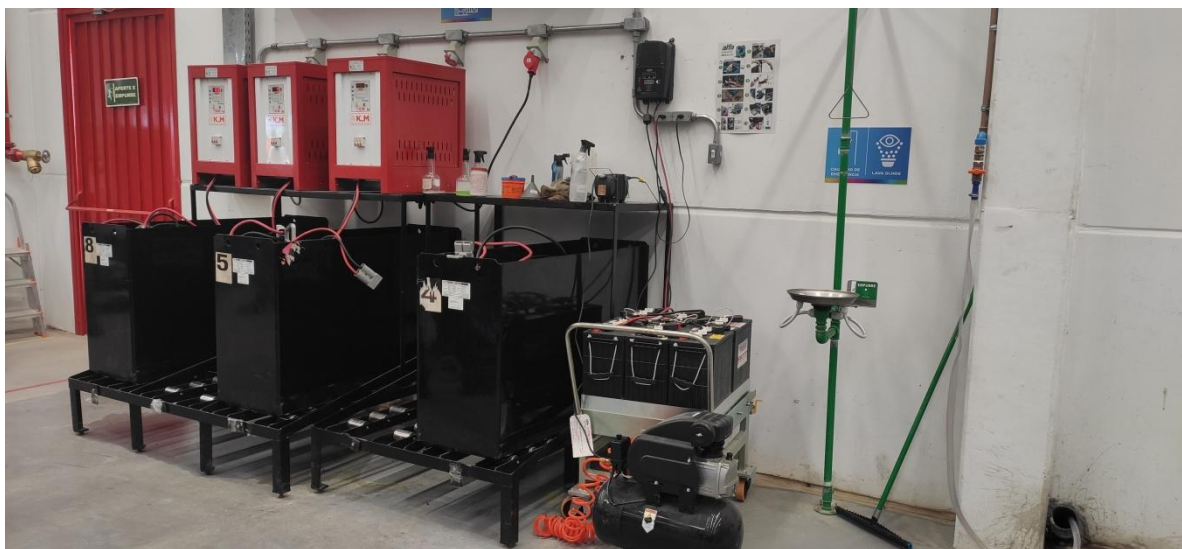
Figura 9. Área de recarga de baterias.
