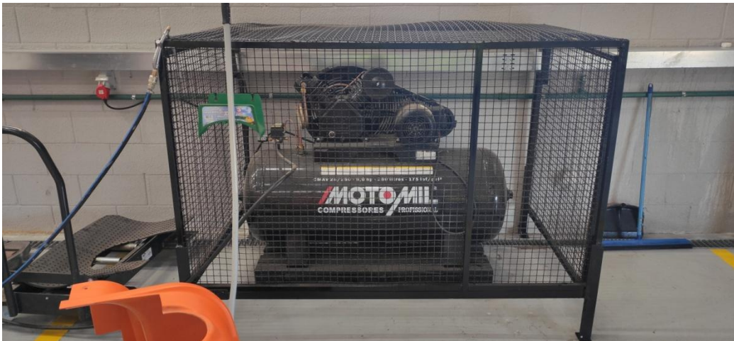
Figura 22. Compressor utilizado na manutenção
