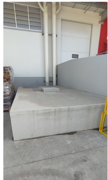
Figura 21. Tanque de contenção de efluentes da área de manutenção e sala de baterias. Capacidade = 8 m 3
