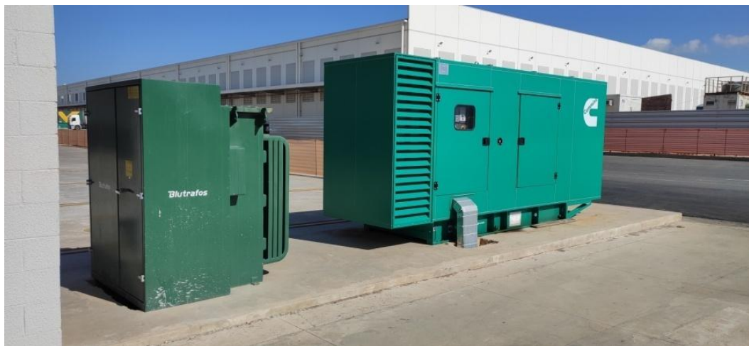
Figura 16. Um dos geradores de energia (backup) do galpão
