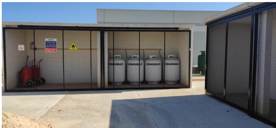
Figura 26. Central de GLP do restaurante do condomínio logístico-industrial
