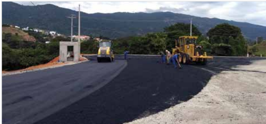
Asfaltamento do Parque de Eventos e melhoria na iluminação pública no entorno
