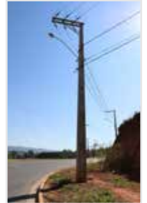
Iluminação no acesso ao Jardim Bela Vista
