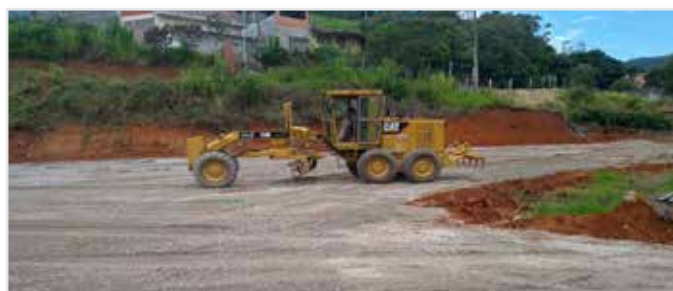
Ampliação dos estacionamentos dos Parques Municipais da Cachoeira do Salto e do Jaguari
