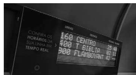
Figura 35: Exemplo de Painel de Mensagens Variáveis instalado em ponto de parada (Goiânia)
