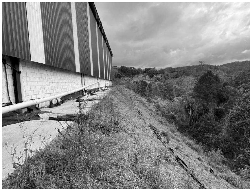
Figura: Talude sem proteção ao lado do galpão. Fonte: Autor, agosto/2023.
