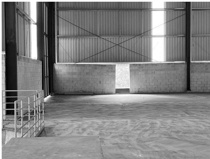
Figura: Desnível na alvenaria. Fonte: Autor, agosto/2023.
