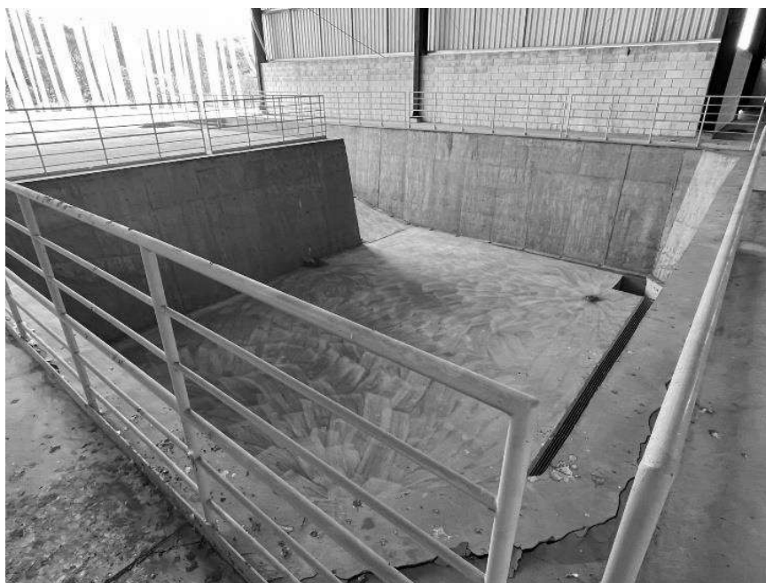
Figura: Trinca no piso do fosso de armazenagem de CDR. Fonte: Autor, agosto/2023.
