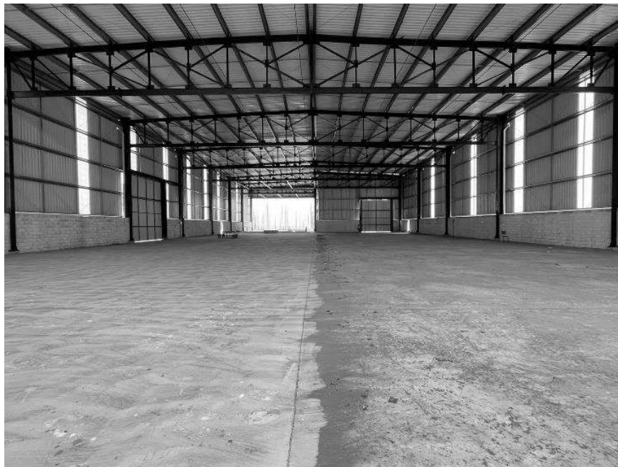
Figura: Foto interna do galpão de processamento de CDR. Fonte: Autor, agosto/2023.
