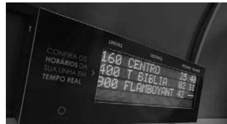
Figura 1: Exemplo de Painel de Mensagens Variáveis instalado em ponto de parada (Goiânia)
