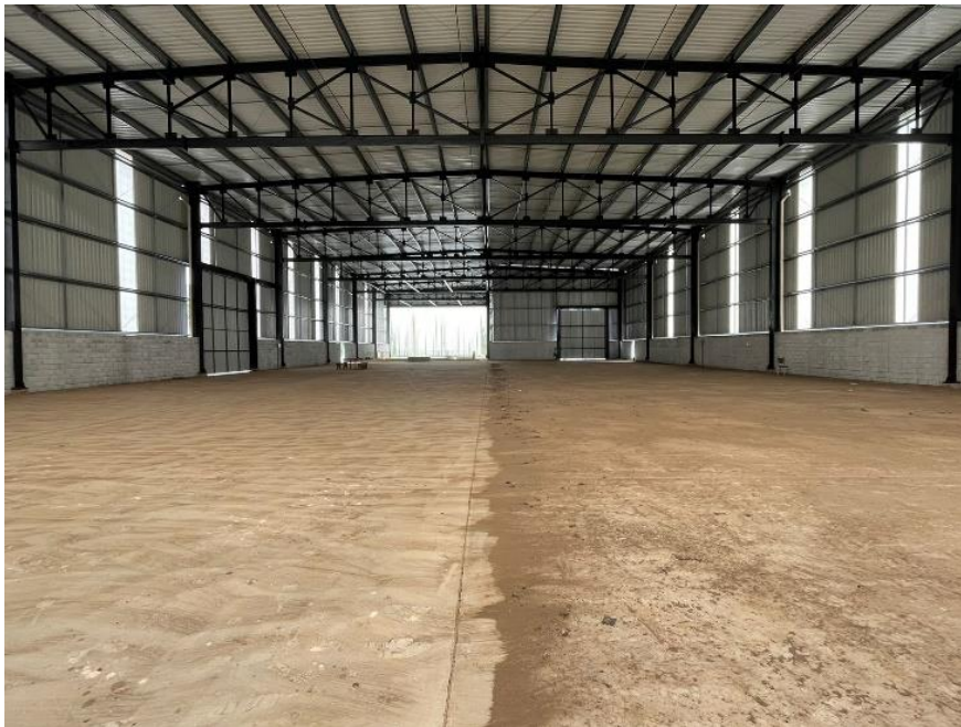
Figura: Foto interna do galpão de processamento de CDR. Fonte: Autor, agosto/2023.
