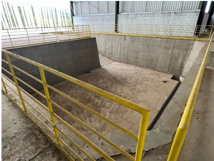
Figura: Trinca no piso do fosso de armazenagem de CDR. Fonte: Autor, agosto/2023.
