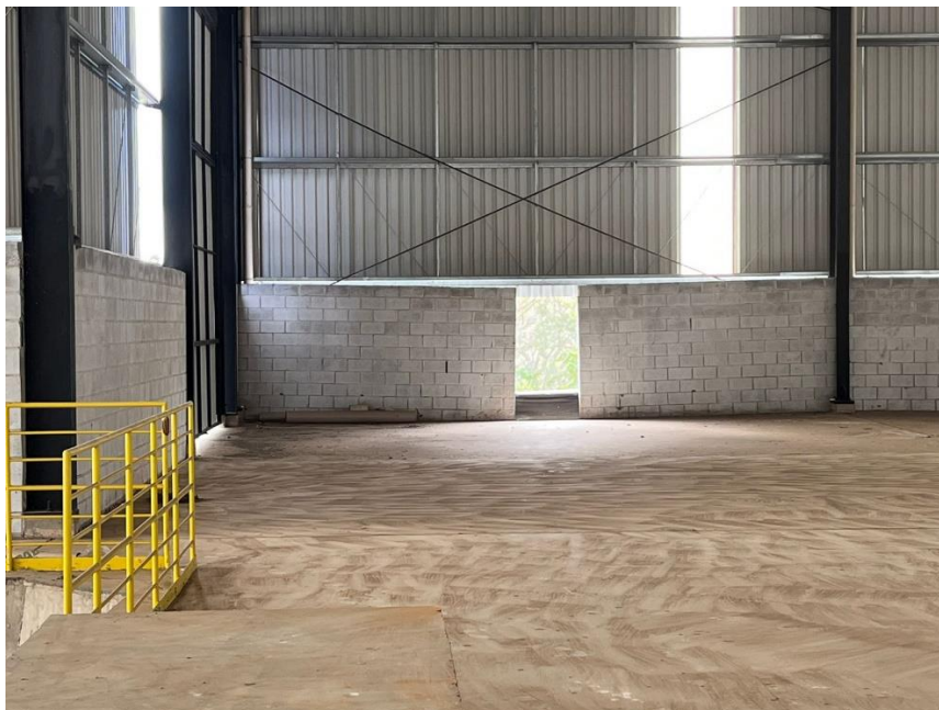
Figura: Desnível na alvenaria. Fonte: Autor, agosto/2023.
